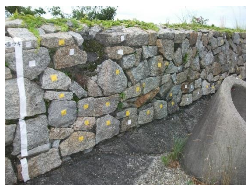
↑写真11 石積み全体の沈下
