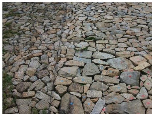
↑写真9 外壁西面北側の損傷状況
