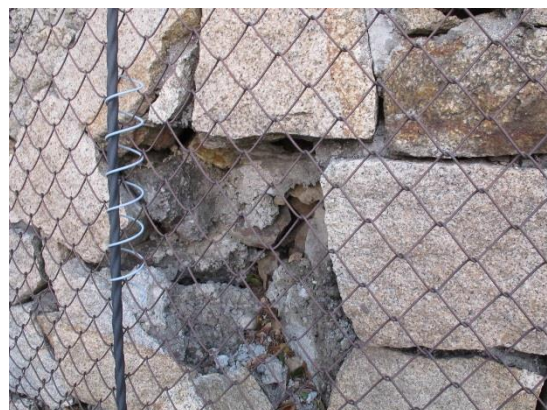
↑ 写真 2 控えが短いことによる脱落石
