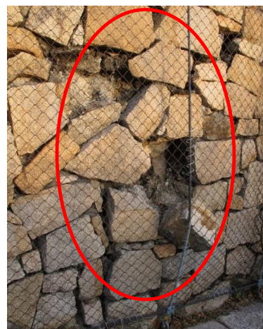
↑ 写真 3 地盤の沈下、石材の脱落
