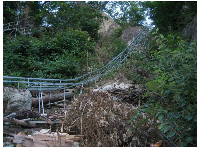
急傾斜に設置されたモノレール施設
